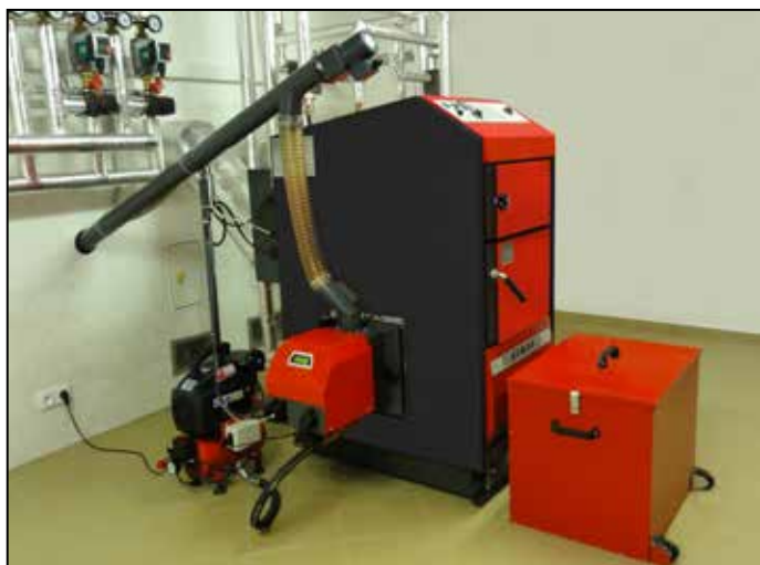
Příklad kotelny s kotlem D50P
