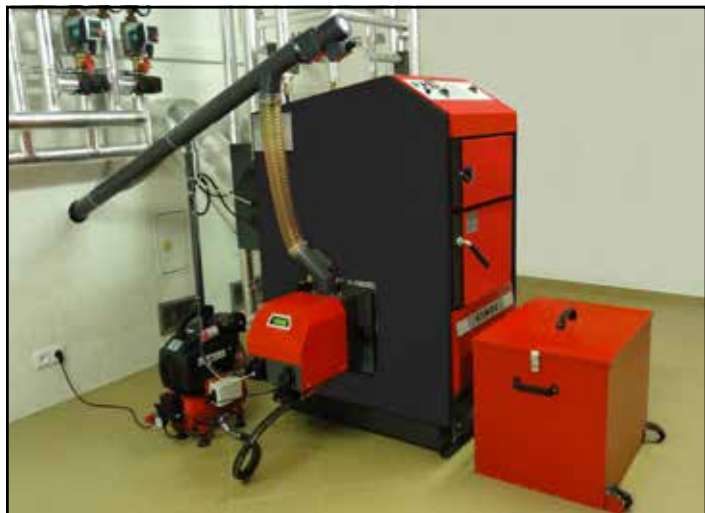
Příklad kotelny s kotlem D50P
