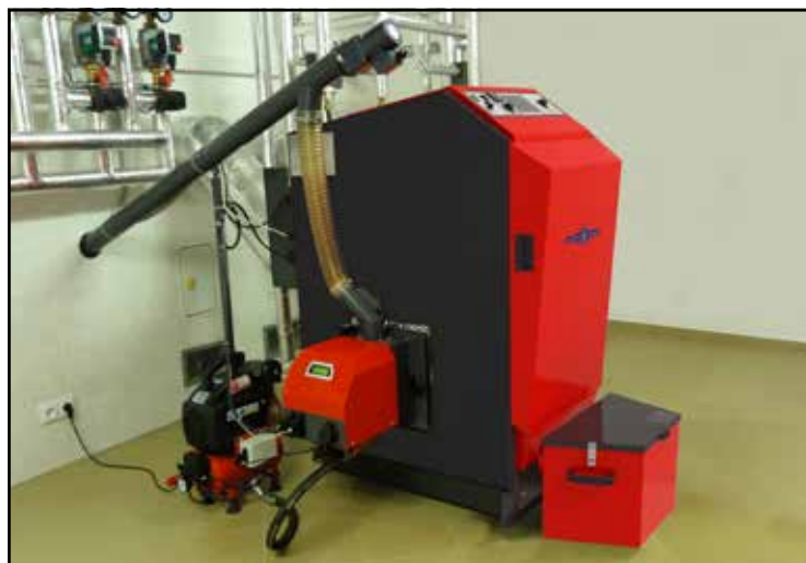
Příklad kotelny s kotlem D50P
