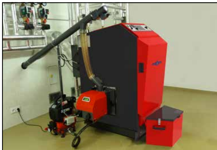
Příklad kotelny s kotlem D50P
